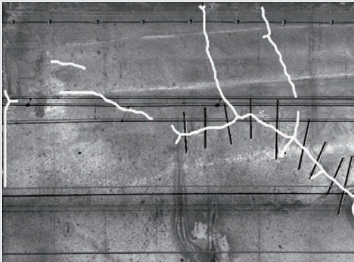
補強材の裏のひび割れだけを識別して検出
