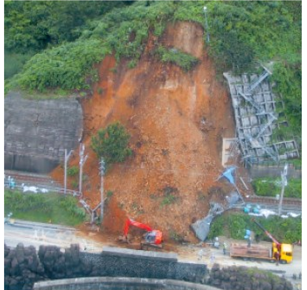
老朽化張コンクリート工の崩壊例
