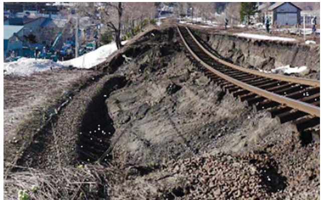
図 融雪期における盛土崩壊の例
