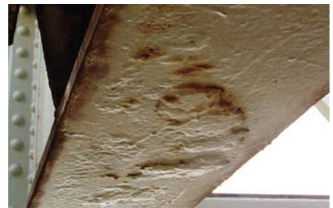
図 塗膜下での腐食が進行した例
