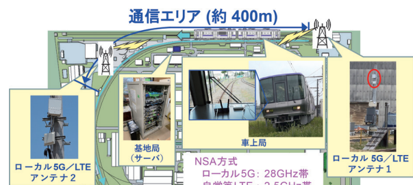
図3 ローカル5Gの設置状況
