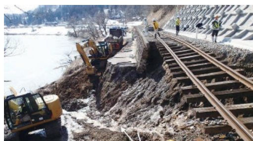
写真2 融雪災害発生後の崩壊面
