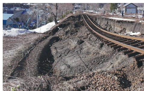
写真1 融雪水の浸透を誘因とした盛土崩壊の例
