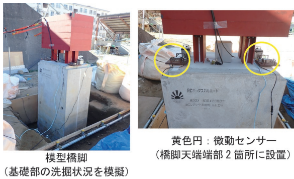
図7 洗掘モニタリングシステムの検証実験
