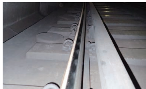
図1 レール波状摩耗の発生状況の例
