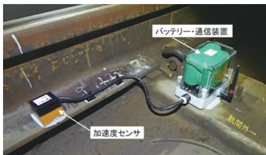
図5 センサユニットの設置状況
