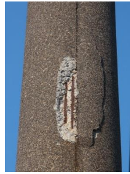
はく離 + 鉄筋露出
