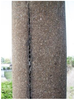
型枠継目 ひび割れ
