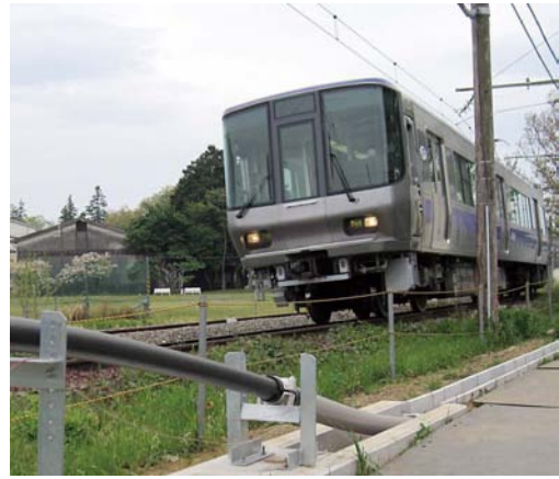
図4-8-2 鉄道用超電導ケーブル
