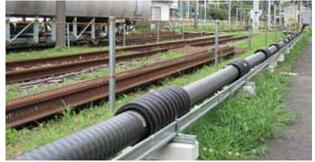
図4-8-1 敷設した300m級超電導き電ケーブル
