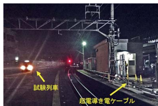
図4-8-1 超電導き電ケーブルを用いた列車走行試験
