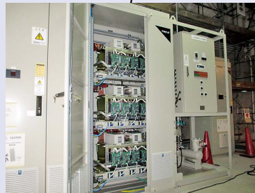
更新した高圧インバータ盤
