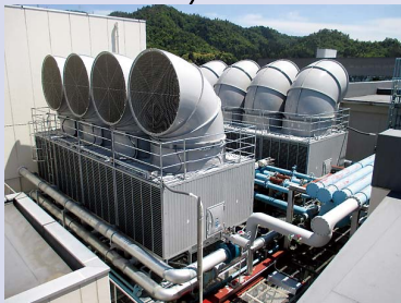
更新した空気冷却装置
