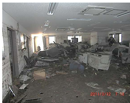
津波により浸水した当時1Fにあった指令室
