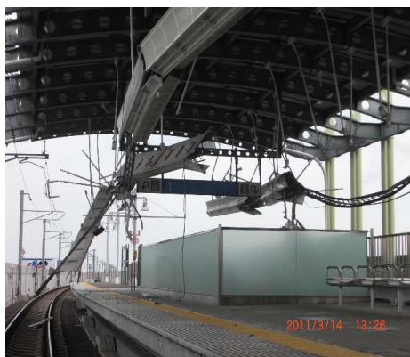
地震により照明ラックが落下(杜せきのした駅)
