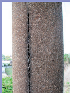
型枠継目 ひび割れ
