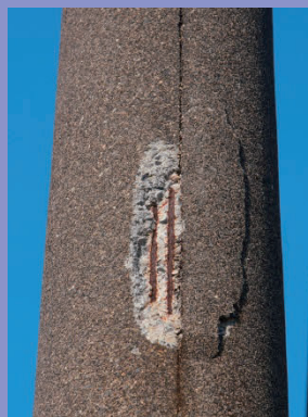
はく離かつ 鉄筋露出
