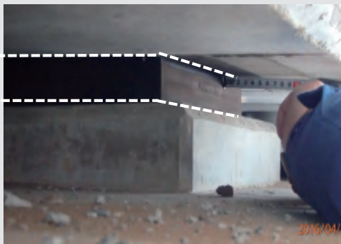
パッドの抜け出し
