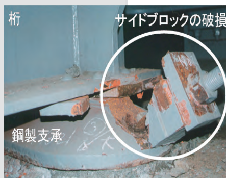
サイドブロック破断 支承の常時・地震時変位
