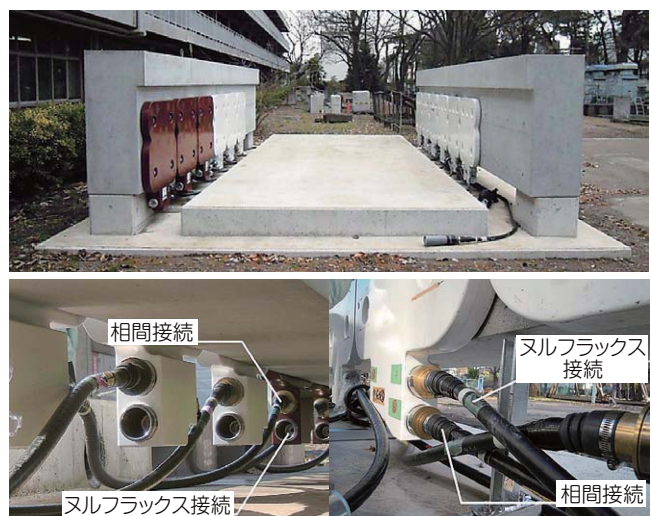
図 実物大模擬ガイドウェイ(上)と ケーブル敷設検証の一例(下)
