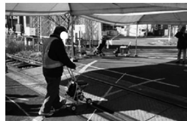
図2 ベビーカー、シルバーカーを用いた踏切隙間を埋める充填材の評価試験の実験風景
