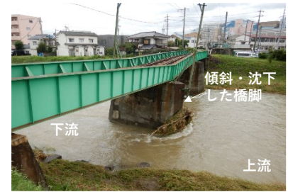
図1 洗掘で被災した橋脚の例
