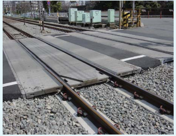
小田急電鉄小田原線 踏切部
