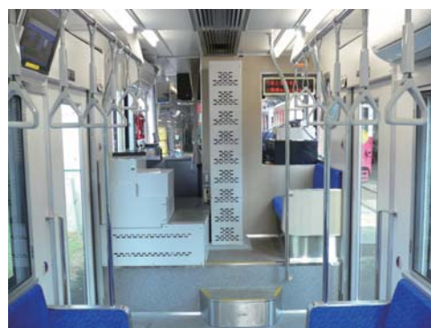
車内のバッテリー配置状態
