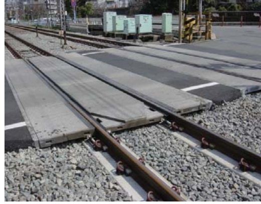
小田急電鉄小田原線 踏切部
