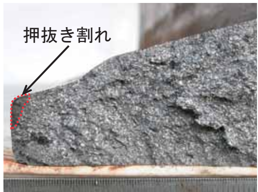
破断試験で現出した押抜き割れ
