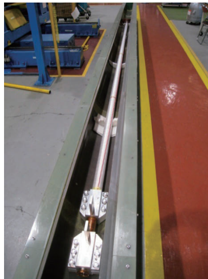
8kA級のき電用超電導ケーブル(外観と断面図)
