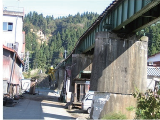
写真1 無筋コンクリート橋脚の目地ずれ被害 (2004年 新潟県中越地震、JR飯山線、魚の川橋梁)
