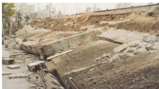
もたれ壁の転倒破壊事例
