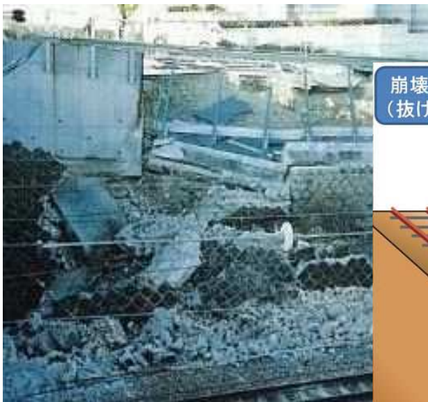
地震による石積み壁の被害状況
