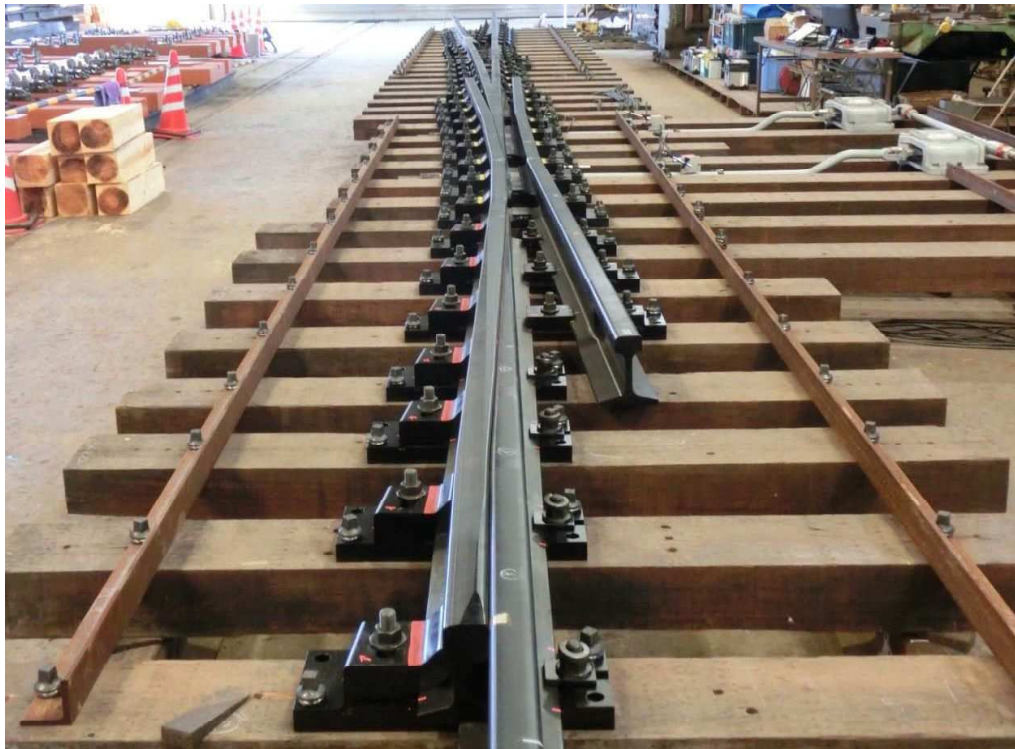
レール鋼製ノーズ可動クロッシングの全景
