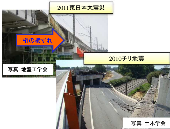
斜角橋台の被災例
