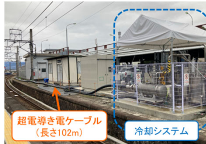
超電導き電ケーブル (長さ102m) 冷却システム
