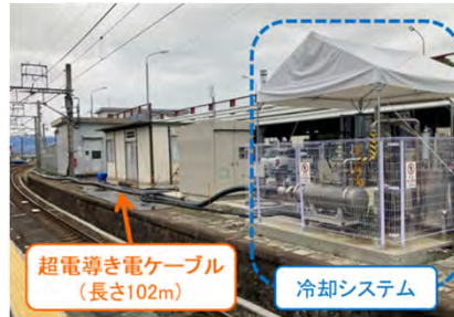
超電導き電ケーブル (長さ102m)
