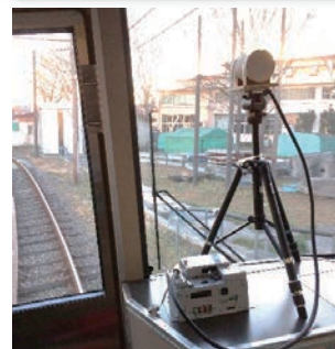
車上無線アンテナ
