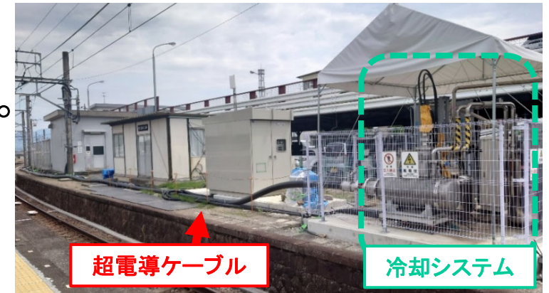
導入した超電導き電システム
