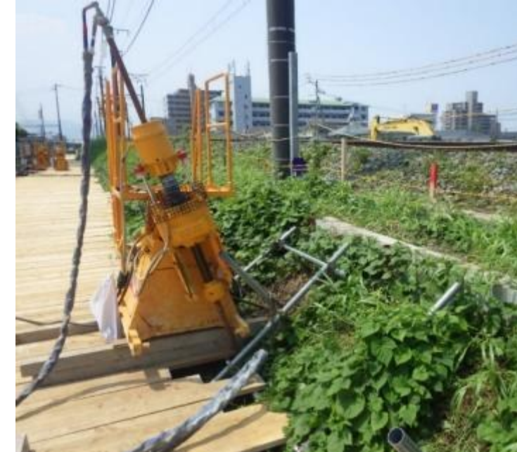
JR四国 予讃線(2021~23) 盛土直下地盤の沈下対策
