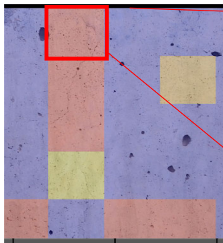
ディープラーニングでひび割れ検出
