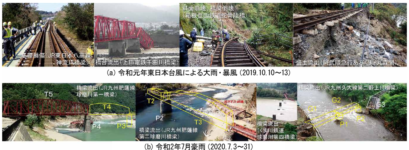
図1 最近の降雨災害による鉄道インフラの被害例
