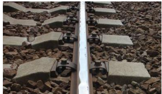
曲線に発生するレール波状摩耗の例
