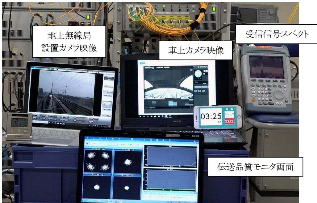
図3 運転席内映像を中央制御装置で受信している様子
