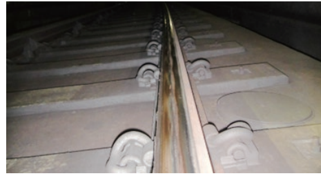
図5 外軌波状摩耗の発生事例(コイルばね防振軌道の例)
