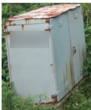
図 13 劣化度が最大の踏切器具箱
