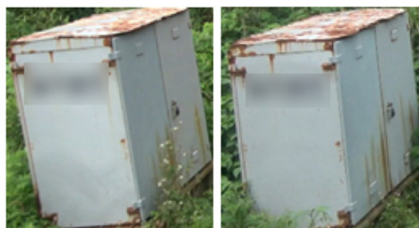
図 16 最も劣化が進行した踏切器具箱の劣化推移
