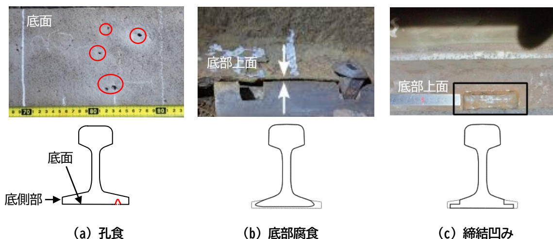
図1 レールの腐食例
