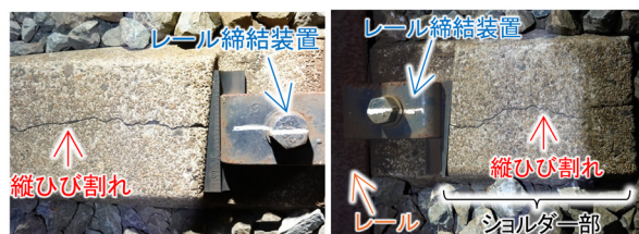
(b) GC 側縦ひび割れ
