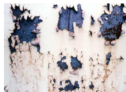
旧塗膜の劣化に 起因する変状例 (剥がれ、割れ)
