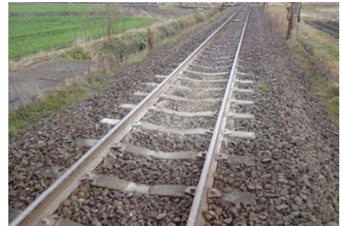
図1 道床劣化箇所の例
