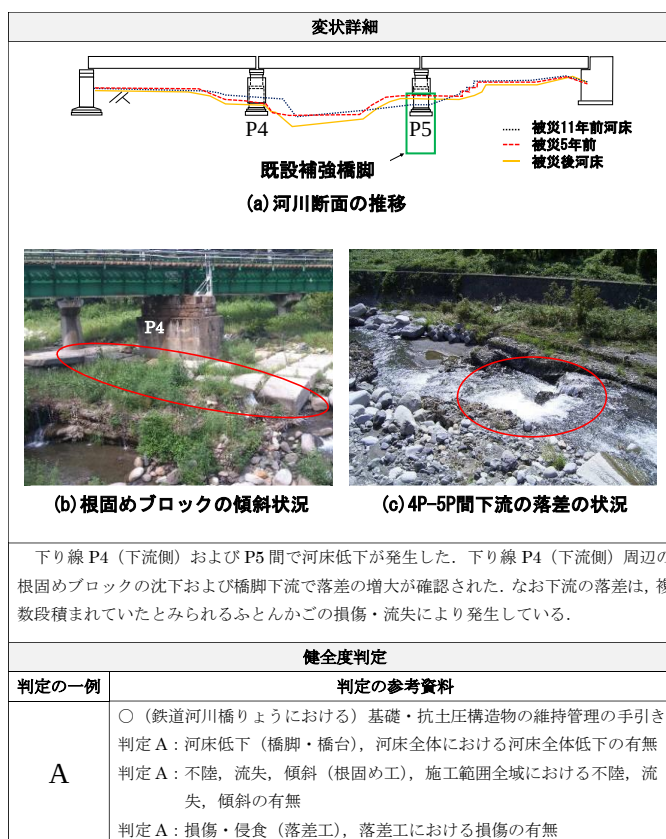
図5 変状の発生状況・健全度判定の例
