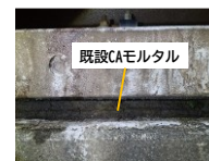
(a) 未補修箇所
