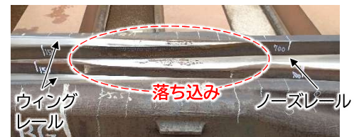
図2 乗り移り箇所の落ち込み
