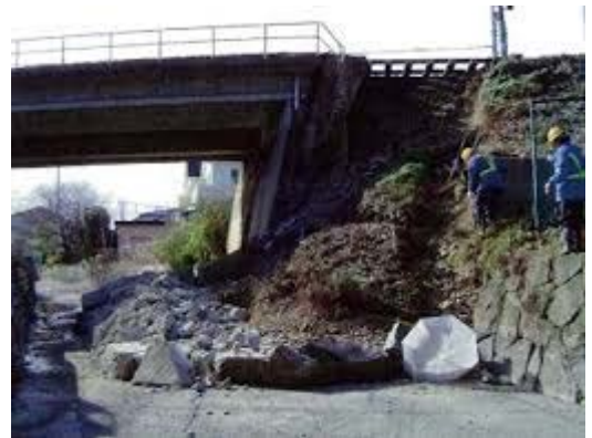
図2 橋台側面のウイングの倒壊 （兵庫県南部地震（1995）） 1)
