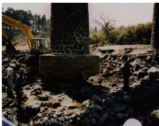
試験により発見した洗堀被害
