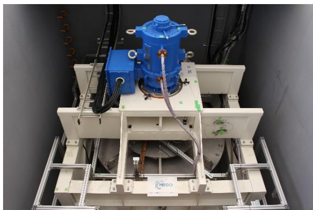
超電導フライホイール蓄電実証試験装置 (山梨県米倉山太陽光発電所内)
