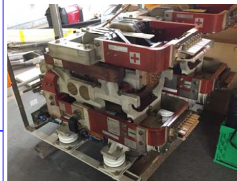
超電導ケーブル回線 直流高速度遮断器
