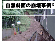
自然斜面の崩壊事例①
