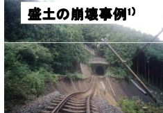
盛土の崩壊事例①
